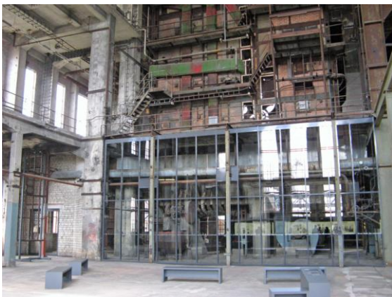
Interiör från det enorma kraftverket med koleldade pannor samt turbiner för elproduktion.
