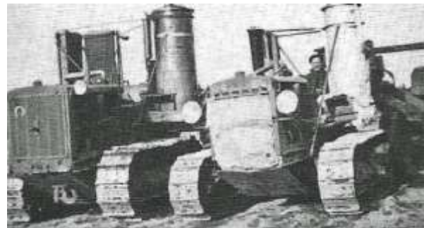
Schaktmaskinerna på Bredåkra hed hade ett hårt arbete vid byggandet av flygfältet.
