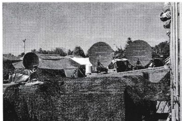
Omsorgsfullt maskerade telecomutrustningar
