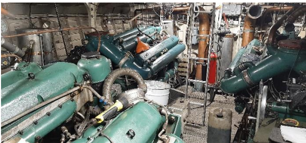
Maskinrummet på MTB T 38 med 3 st 18 cylindriga W motorer på 1500 hk vardera Foto Föreningen T 38
