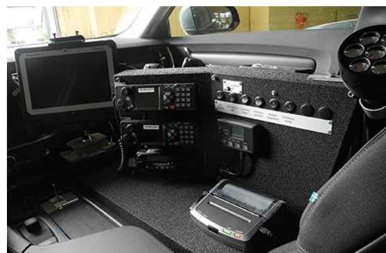
I de nya bilarna har man rivit ut passagerarsätet och installerat en dator för manövrering av systemet samt nödvändiga radiosystem.
